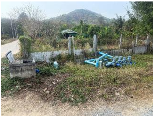
ภาพ วาล์วจ่ายน้ำ
