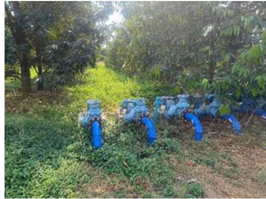
ภาพ วาล์วจ่ายน้ำ
